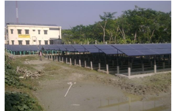
100 KW solar mini grid project at Sandwip
